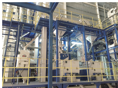
精米設備（初摺機など）
