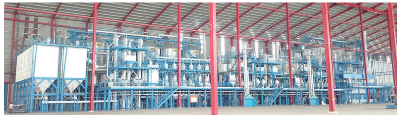
精米設備全景
